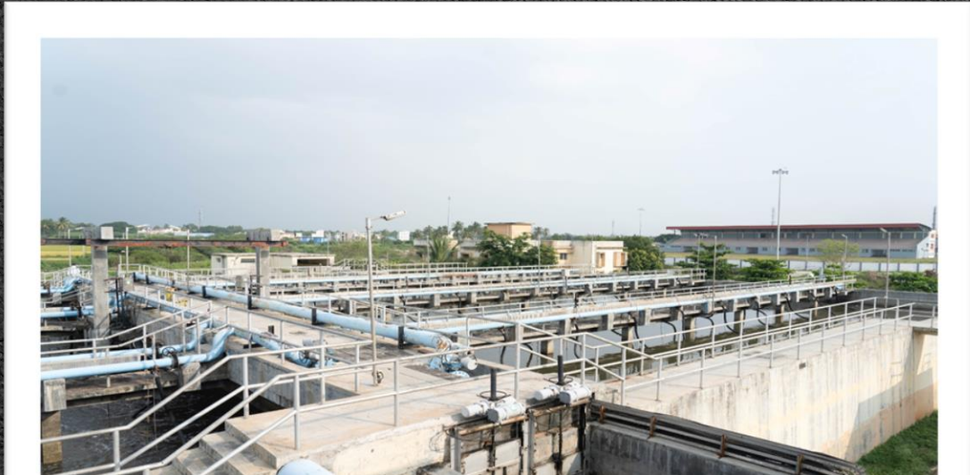
20 MLD SBR Type STP - Davangere CC, Davangere Dt
