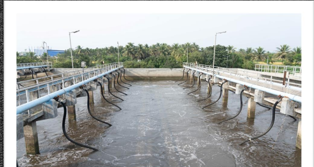
20 MLD SBR Type STP - Davangere CC, Davangere Dt.
